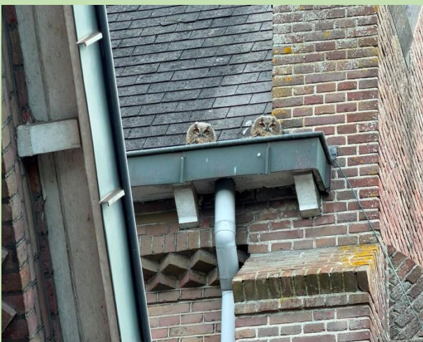
Nieuwsgierige Oehoetjes in dakgoot
